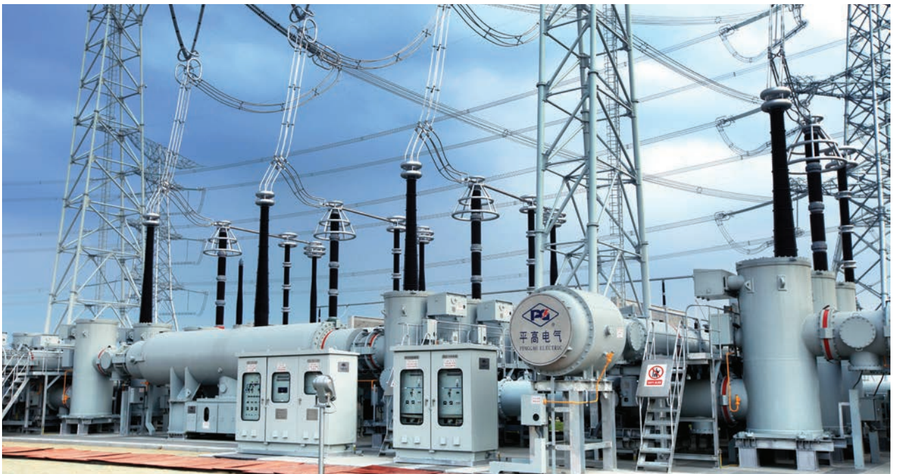
图 1 1100 kV GIS。平高集团供图。
